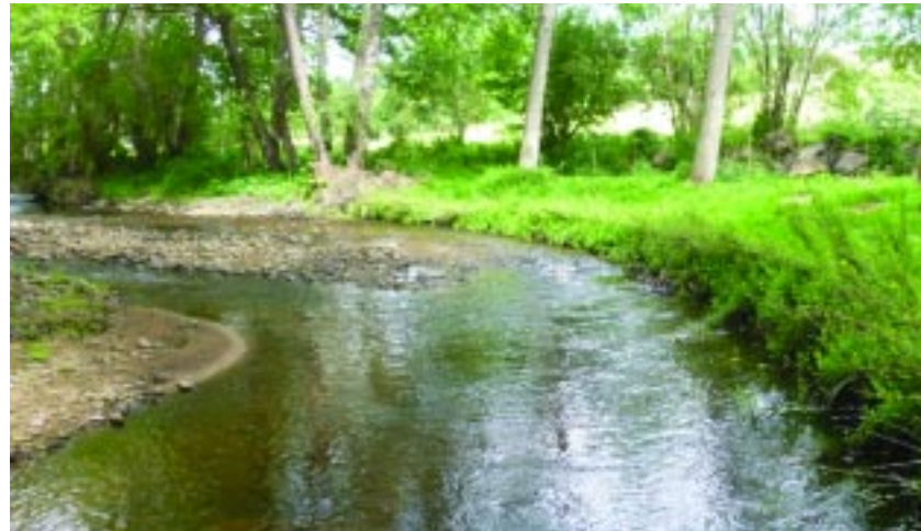
Renaturation de 30 mètres de berge afin de remplacer un enrochement surplombé par un merlon grâce à un aménagement : dérèglement de la berge, talutage en pente douce et intégration de végétal
